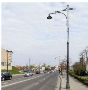
Pav. 2.2. Šviestuvai Pilies g.
