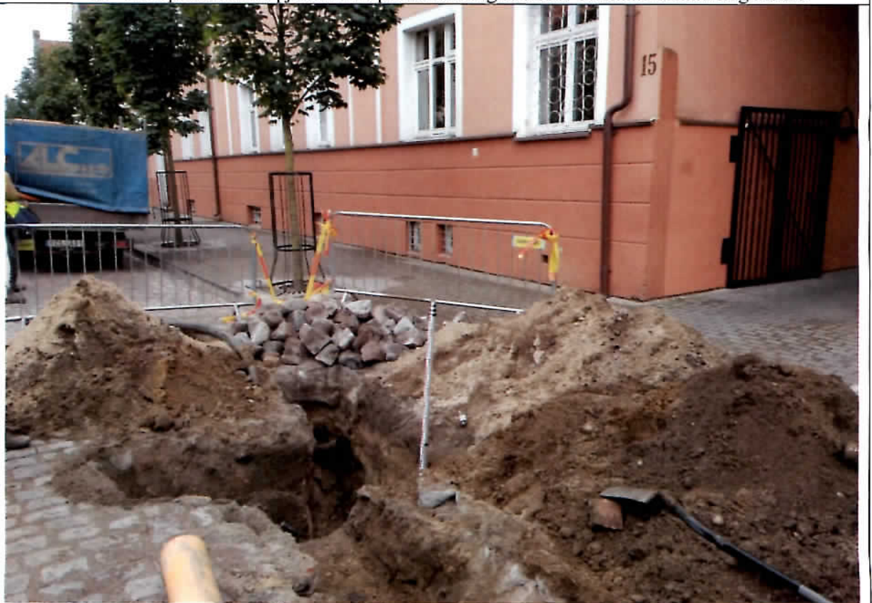
7. Pr. 2 bendras vaizdas iš Š pusės. Prieduobė iškasta priešais įvažiavimą į K. Donelaičio g. sklypo nr. 15 vidinį kiemą
