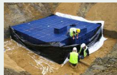
Akumuliacinės (ir infiltracinės) talpos
