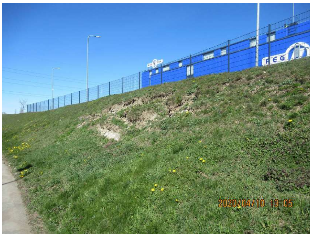
Nuotrauka Nr. 1. Šlaito nuošliauža šalia sklypo adresu Šiaurės pr. 25, Klaipėda.
