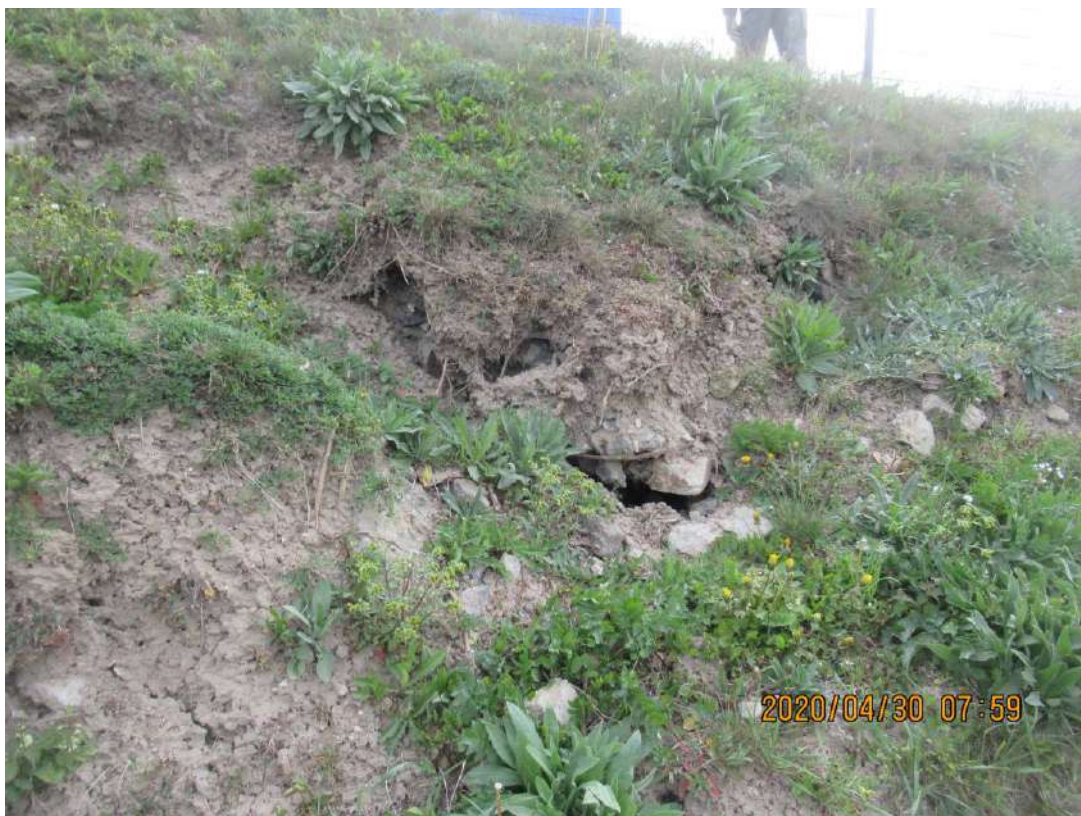
Nuotrauka Nr. 5. Šlaito nuošliaužos vietoje atsidenęs statybinis laužas.
